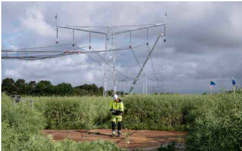
Rejsning af højspændingsmaster kaldet Thors Hammer på Energinets Vestkystforbindelse. Der er tale om en 400 kV forbindelse mellem Idomslund (nær Holstebro) og Endrup. Ca. 2,5 km før Tarm kan man se den store transformerstation, der er forbundet til forbindelsen.
