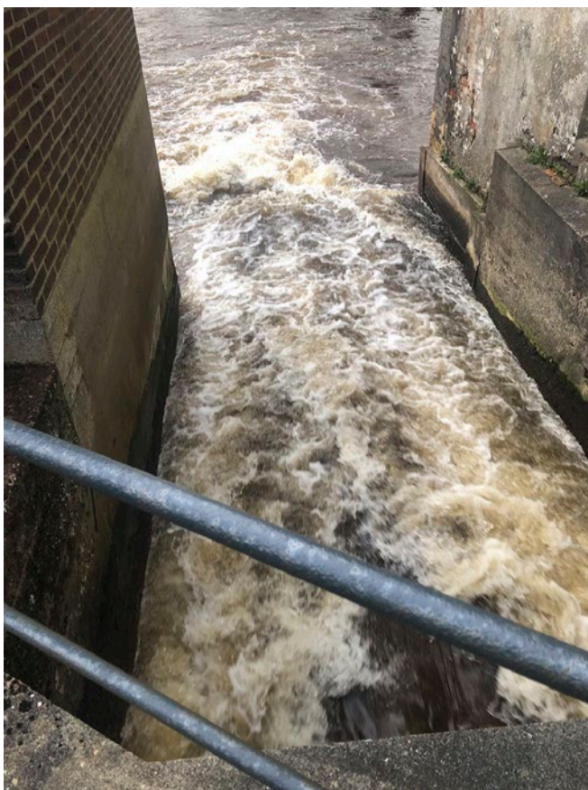
Vandet fra den lukkede turbine.
